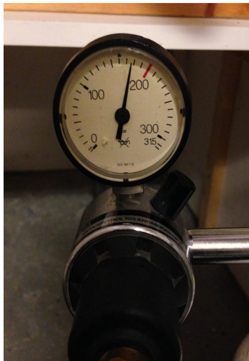
Exempel på manometer.
